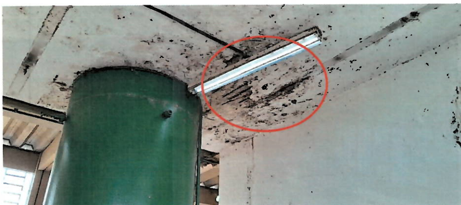
Foto 28 – Ferragens expostas no teto da EEAB BRG
