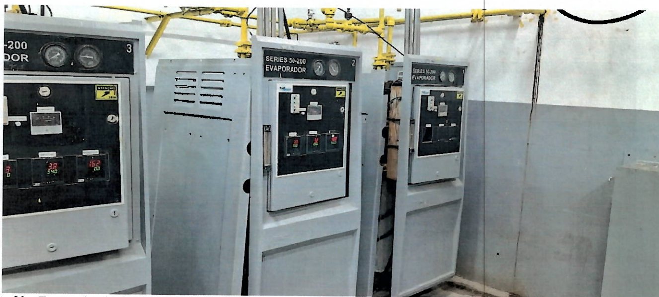
Foto 80 – Evaporador de cloro. Nota-se que as placas laterais de acabamento estão desafixadas e que há leitores de monitoramento inoperantes.
