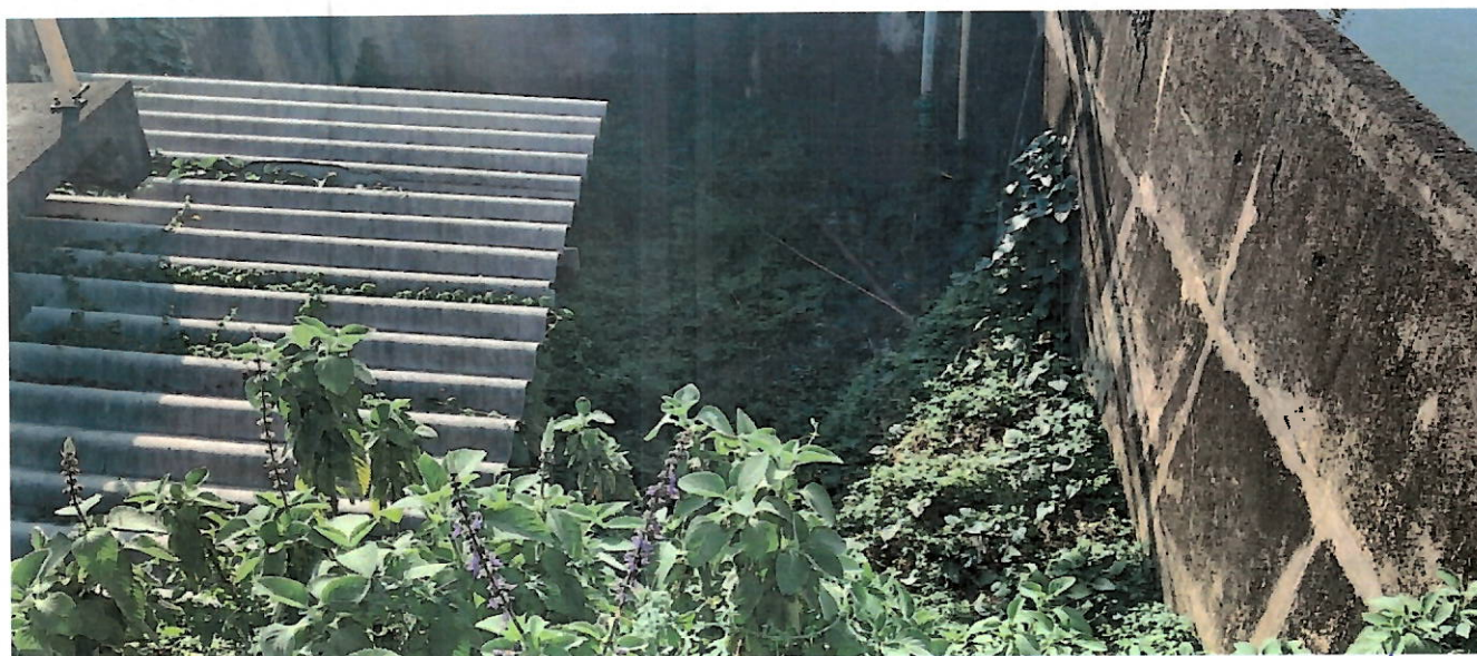
Foto 64 – Área entre floculação e decantação precisando de limpeza.
