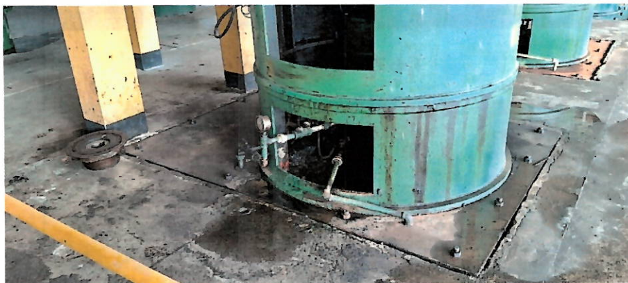
Foto 27 – Um dos conjuntos motobombas apresentando vazamento
