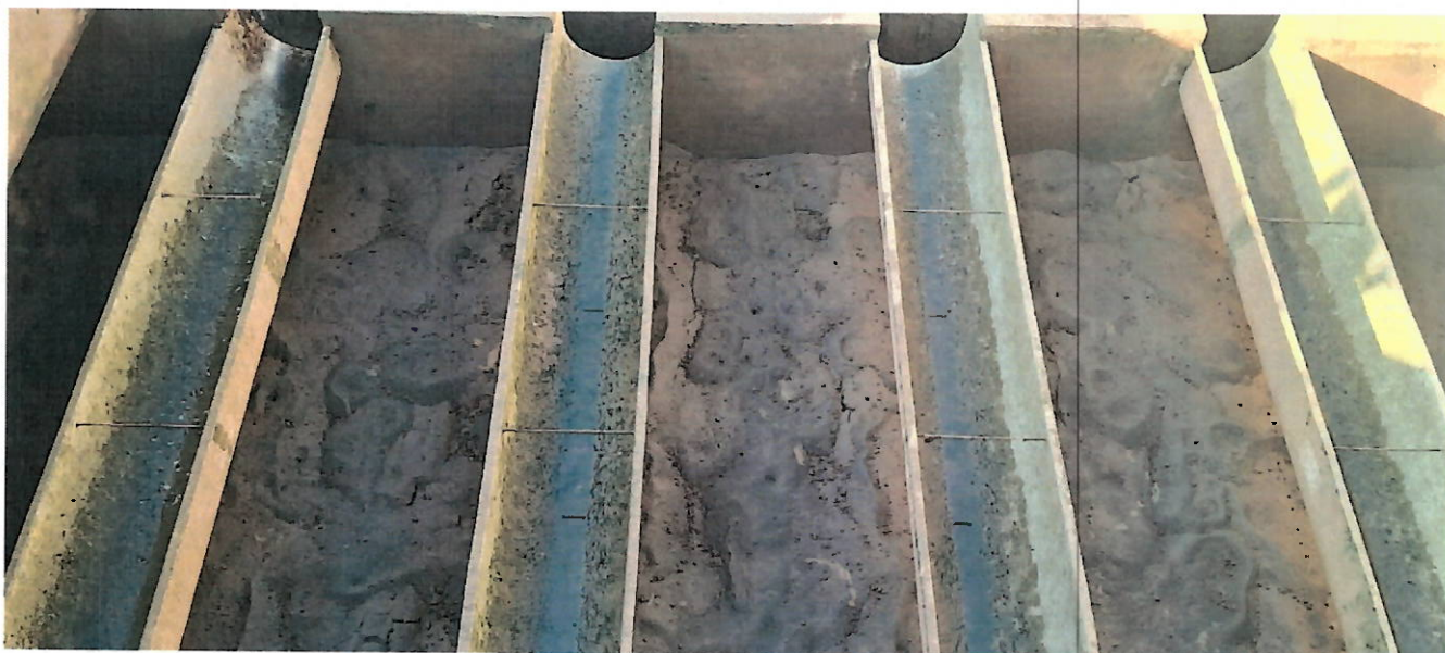
Foto 69 – Filtro vazio em processo de limpeza.
