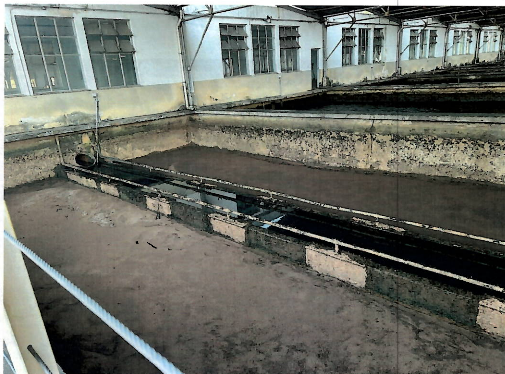
Foto 51 – Filtro vazio em processo de limpeza.
