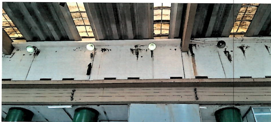
Foto 29 – Sinais de vazamento e crescimento de vegetação no teto da EEAB
