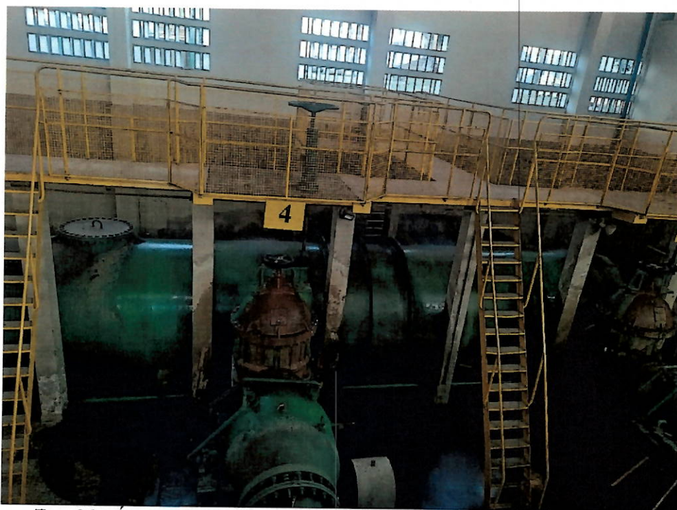
Foto 96 – Área com vazamento na tubulação de recalque da ARG.
