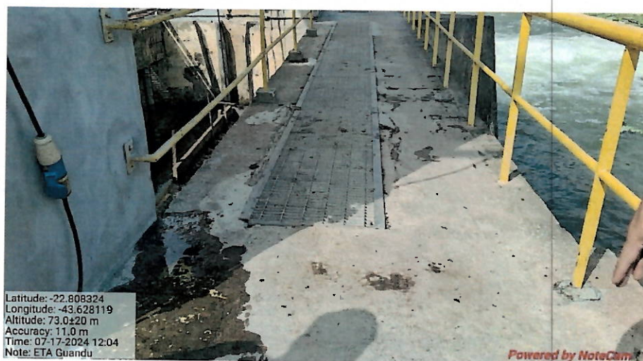
Foto 7 - Passarela na crista da barragem apresentando desgaste estrutural
