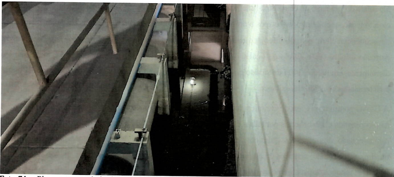
Foto 74 – Piso, entre a galeria de válvulas e a elevatória de lavagem, com água corrente devido a vazamento em válvula.
