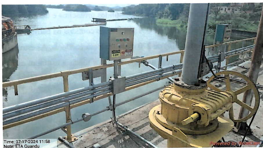
Foto 13 - Painel de automação do gradeamento
