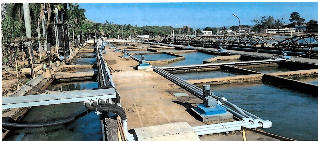
Foto 43 – Vista geral da área de floculação, nota-se ausência de guarda-corpos de proteção.
