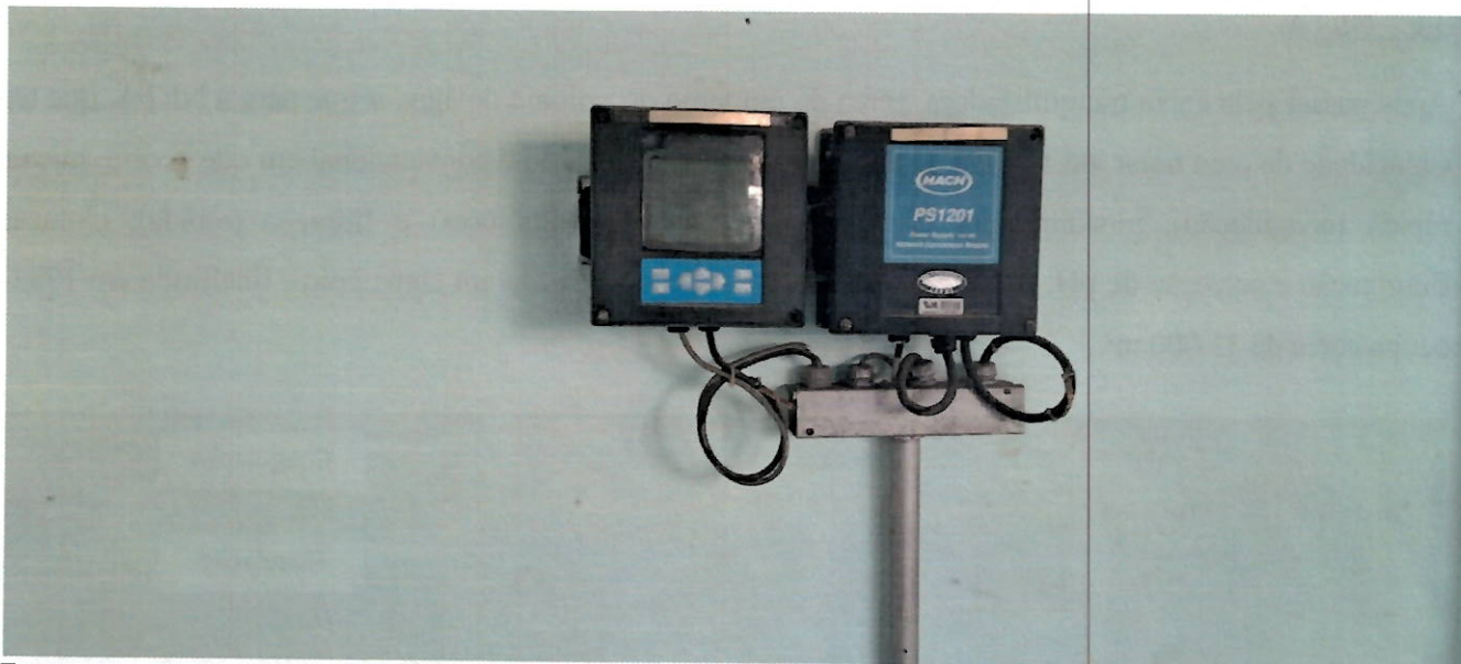
Foto 54 – Equipamento eletrônico de monitoramento da água nos filtros inoperante. Foram verificados outros equipamentos em situação semelhante.
