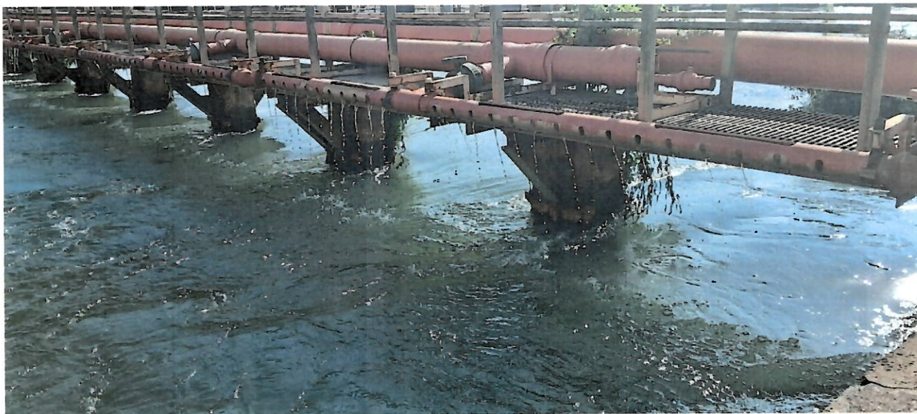
Foto 38 – Ponto de aplicação de coagulantes na caixa tranquilizadora.
