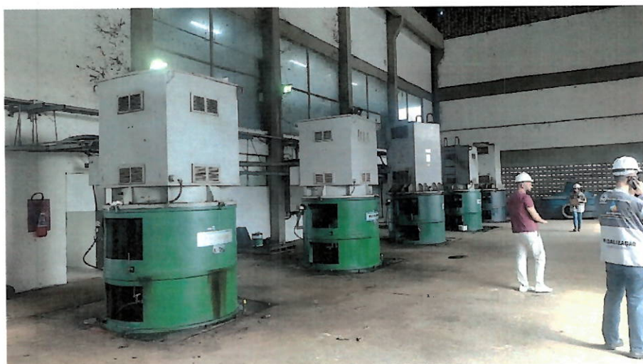
Foto 32 – Abrigo da EEAB NBRG e visualização dos 5 conjuntos motobombas
