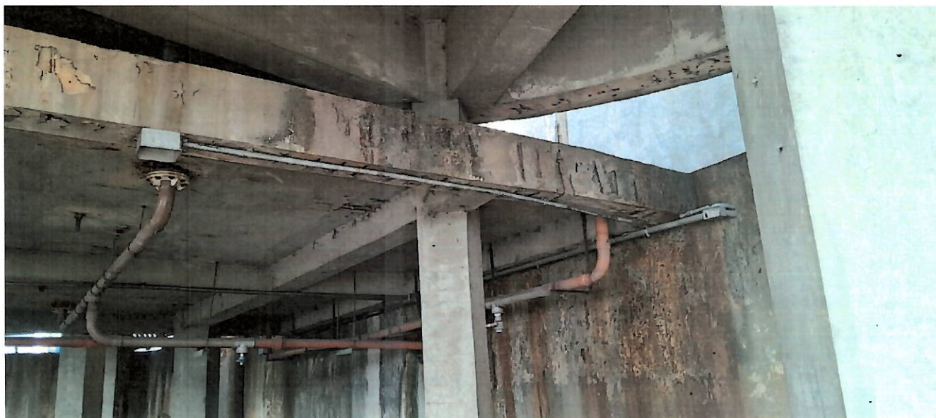
Foto 85 – Viga dos reservatórios de sulfato de alumínio com armadura exposta.
