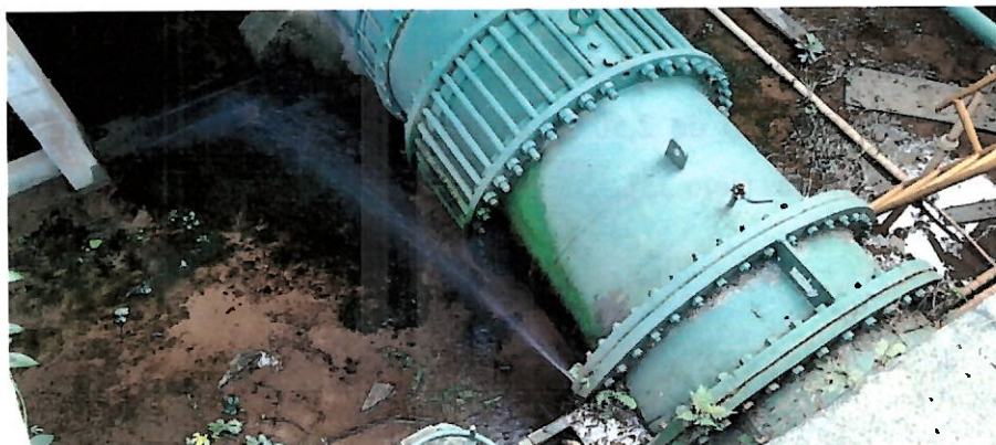
Foto 33 – Vazamento identificado em uma das adutoras
