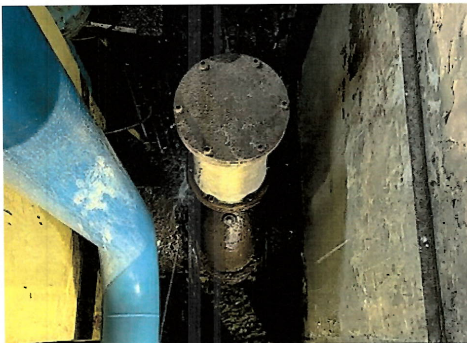
Foto 75 – Válvula da tubulação de saída dos filtros com vazamento.
