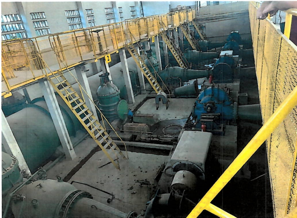
Foto 95 – Interior da Casa de bombas da ARG. Nota-se que um o CMB 2 estava inoperante.
