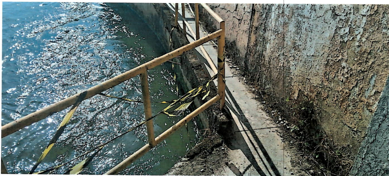
Foto 40 – Guarda corpo danificado entre a caixa tranquilizadora e a VETA.
