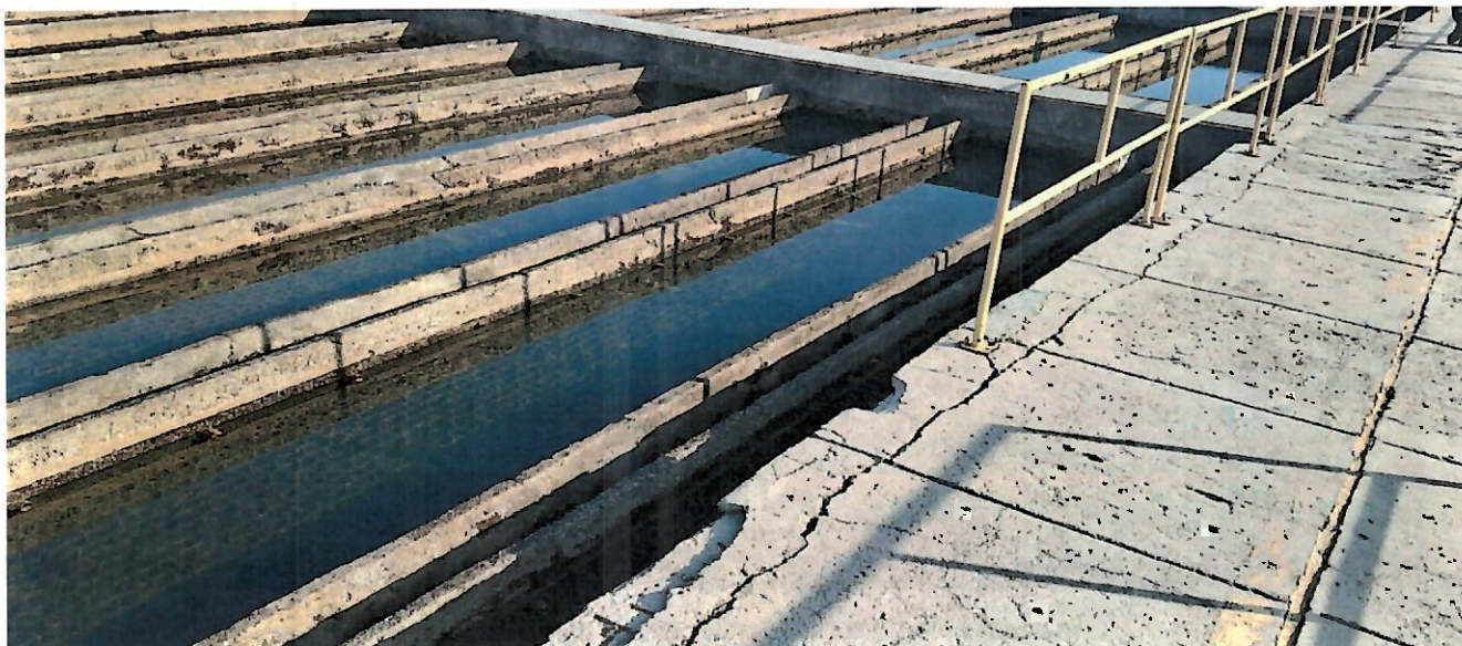
Foto 66 – Área com piso deteriorado e guarda-corpo ausente.
