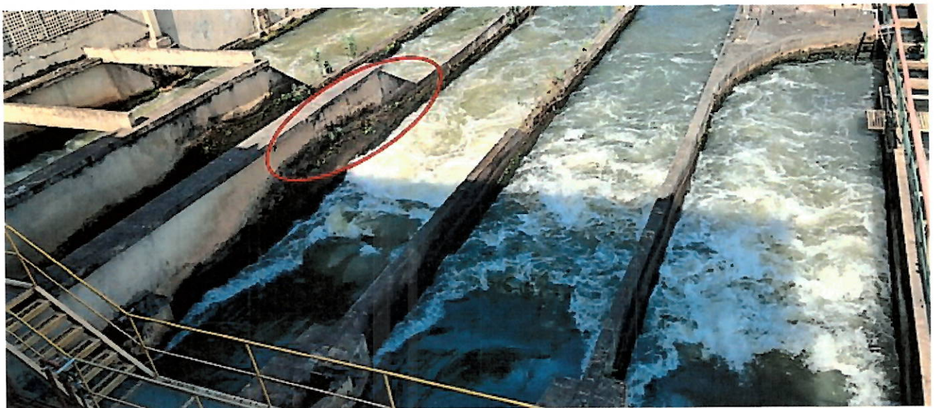
Foto 41 – Vista superior das Calhas Parshall. Detalhe à esquerda do deslocamento do revestimento da parede de uma das calhas.
