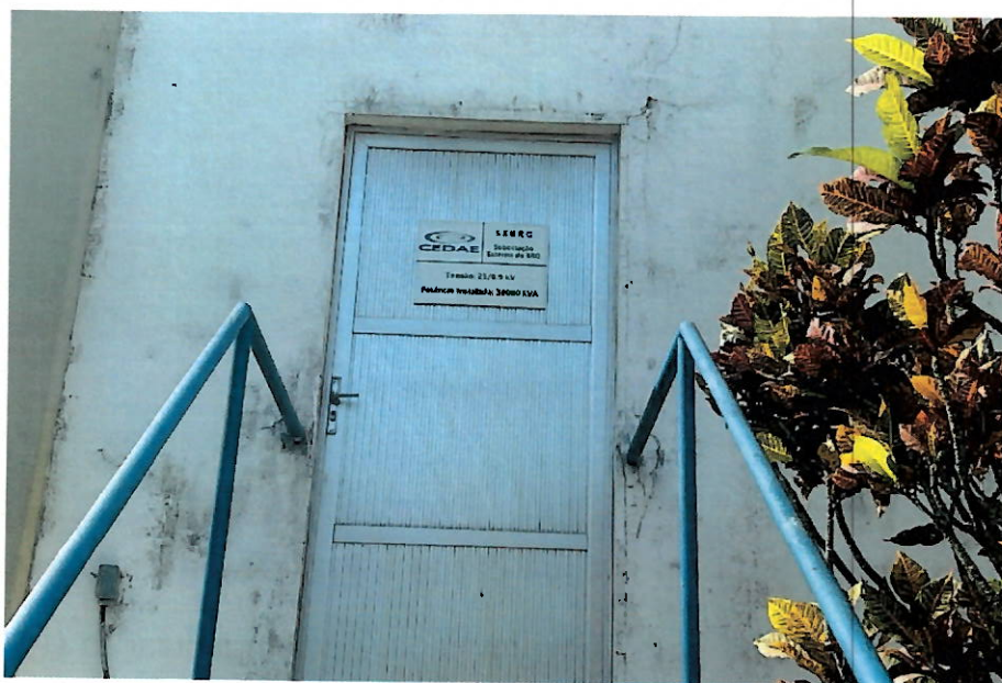
Foto 34 – Entrada do abrigo dos equipamentos elétricos da subestação com informações técnicas
