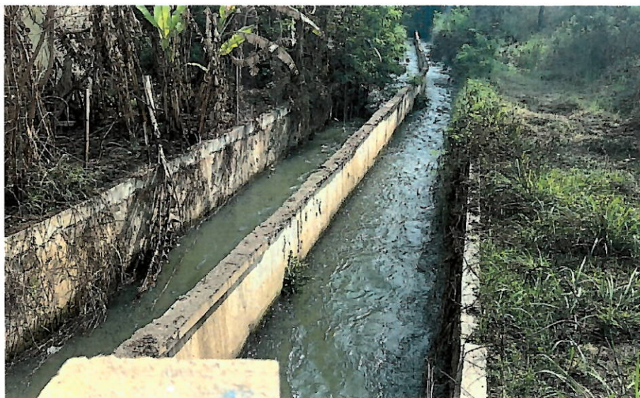
Foto 16 - Estrutura dos túneis de chegada da água da captação sem tampa
