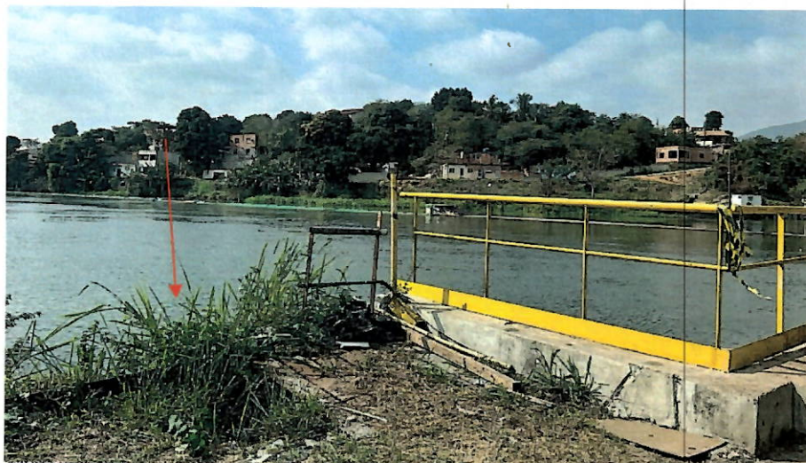
Foto 10 - Local desprotegido de guarda-corpo próximo a barragem
