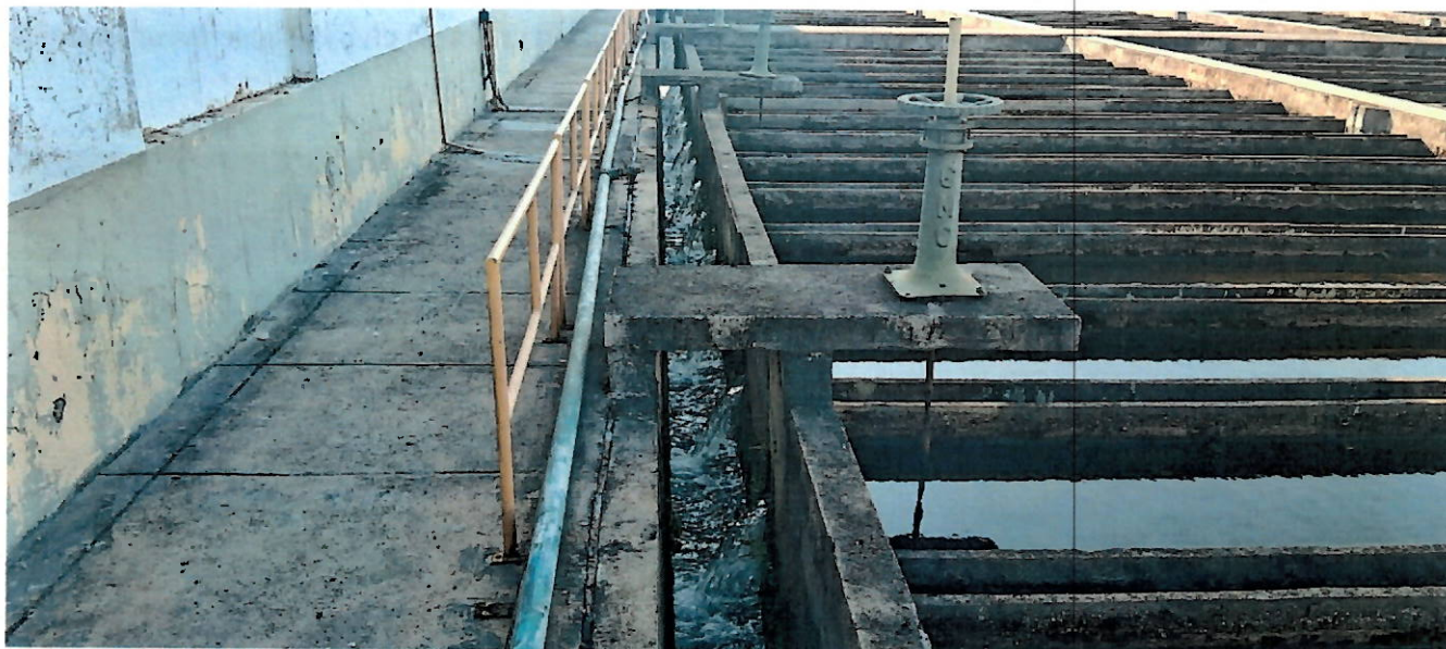
Foto 67 – Canaleta de coleta da água decantada.
