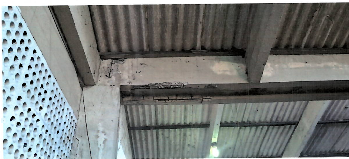
Foto 78 - Vigas danificadas da estrutura do telhado da Casa de Química.
