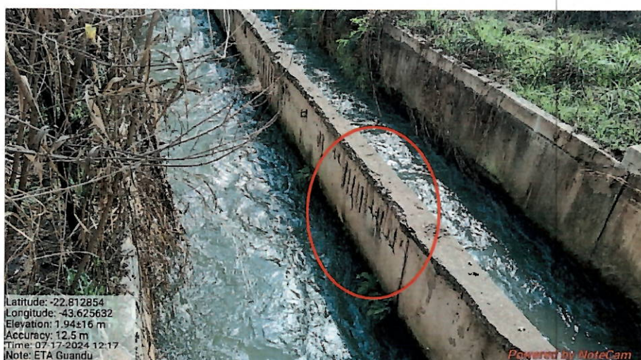
Foto 15 - Túnel de chegada da água em má estado de conservação, sem tampa
