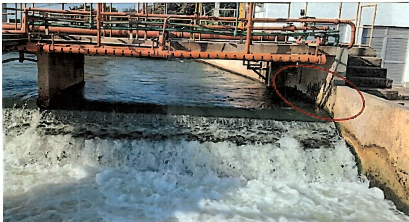
Foto 57 – Vertedouro para mistura rápida na NETA, ao fundo calha para aplicação de coagulantes. À direita verifica-se revestimento do concreto danificado e armadura exposta.
