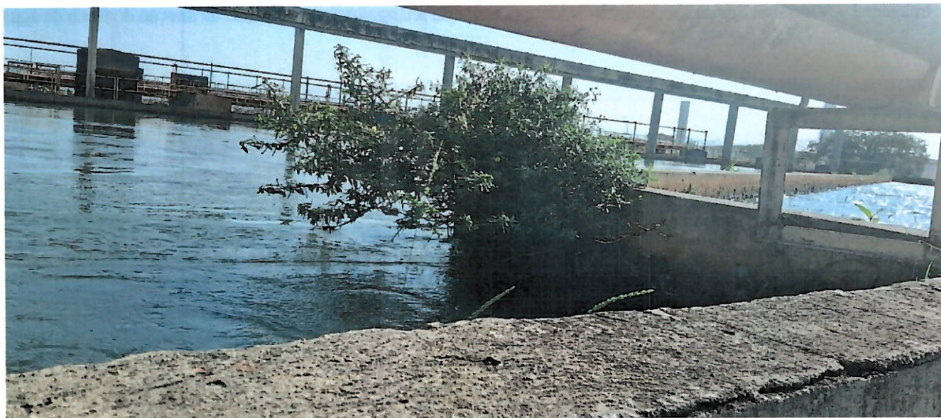
Foto 39 – Detalhe da presença de vegetação na parede da chicana da caixa tranquilizadora.
