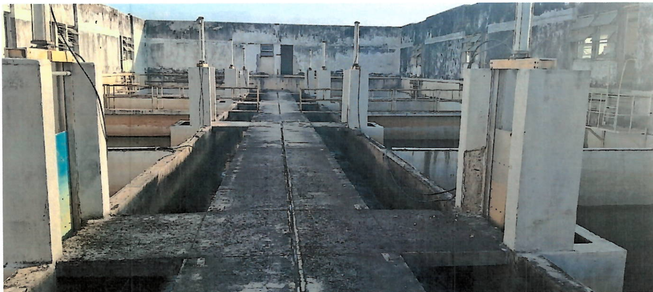
Foto 71 – Corredor entre os tanques de filtração. Área necessita instalação de guarda corpos e outras melhorias civis.
