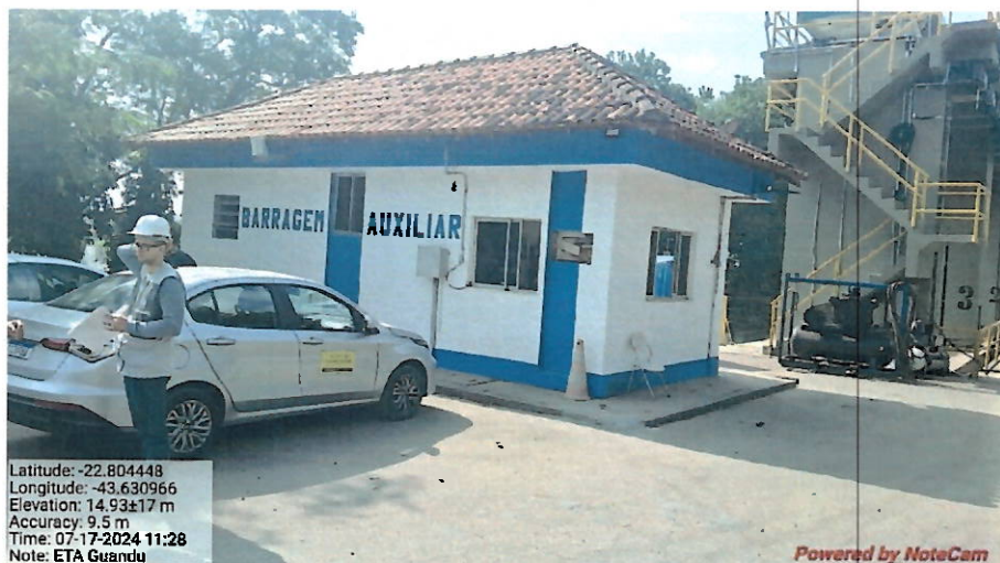
Foto 2 - Abrigo dos painéis de comando da barragem auxiliar.
