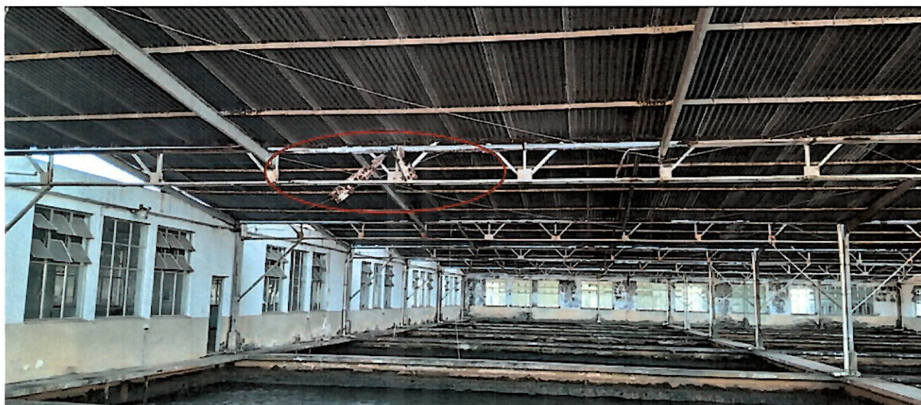
Foto 53 – Calha do telhado deteriorada. Havia outros pontos do telhado também necessitando melhorias.
