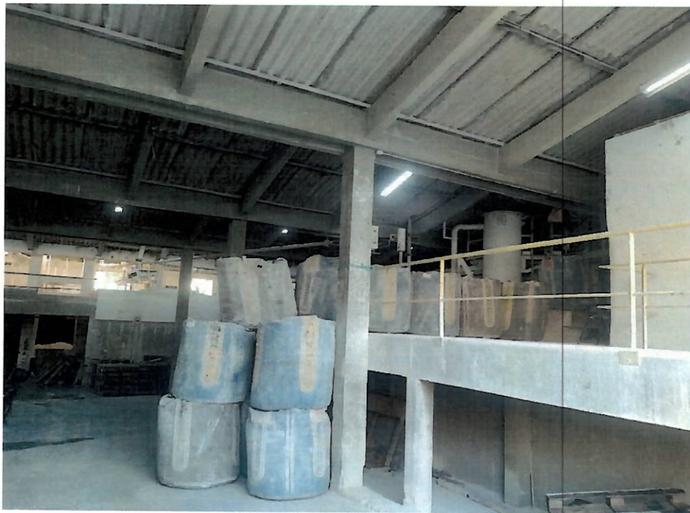
Foto 83 – Vista do interior da unidade de correção de pH.
