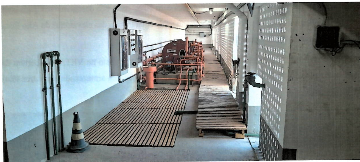
Foto 77 - Sistema de dosagem dos coagulantes.
