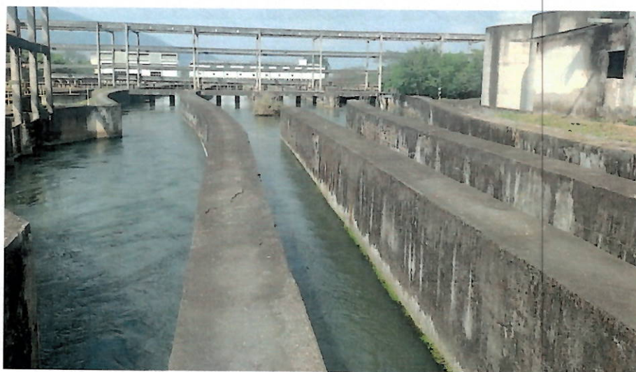
Foto 19 - Desarenadores da água bruta
