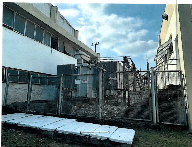
Foto 35 – Visualização da subestação
