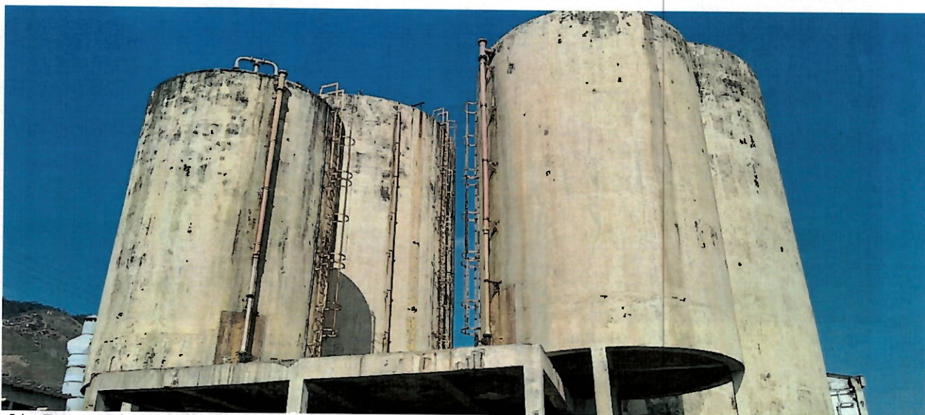
Foto 84 – Reservatórios de concreto armado de solução de sulfato de alumínio. Dois tanques possuem diâmetro de 6,6 m e altura de 8,0 m, e os outros dois com diâmetro de 12,0 m e 15,0 m de altura.
