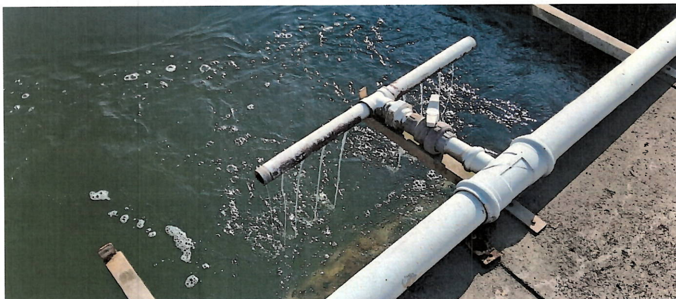
Foto 60 – Ponto de aplicação de coagulante nos floculadores.
