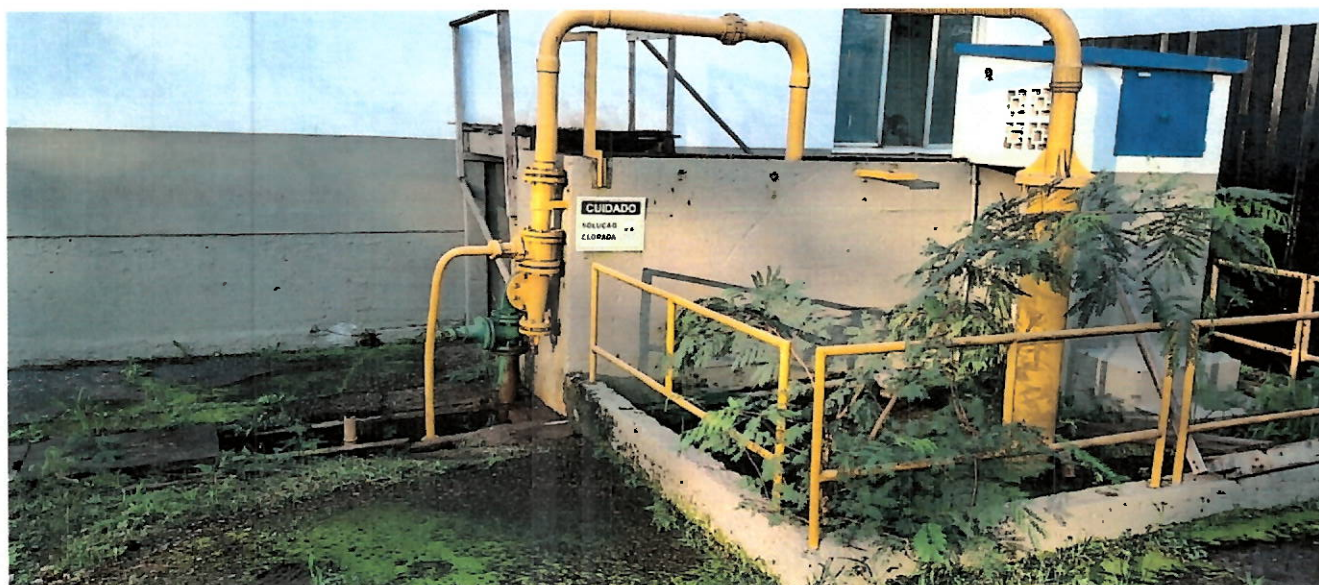
Foto 82 – Um dos pontos em que é aplicada solução clorada na água após a água passar pelos tanques de filtração. Nesse ponto havia vazamento de solução clorada.
