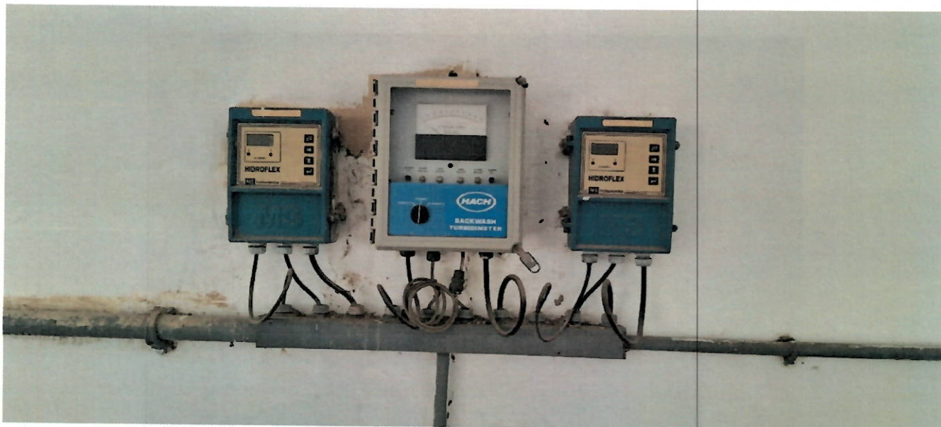
Foto 73 – Turbidímetro e outros equipamentos de monitoramento inoperantes.
