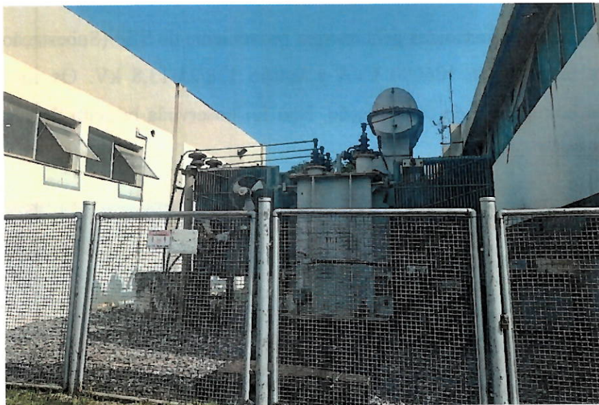
Foto 36 – Visualização da subestação
