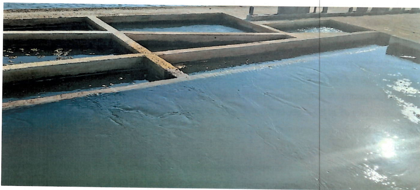
Foto 45 – Tanque flocculador “trabalhando afogado”, o que indica problema operacional.
