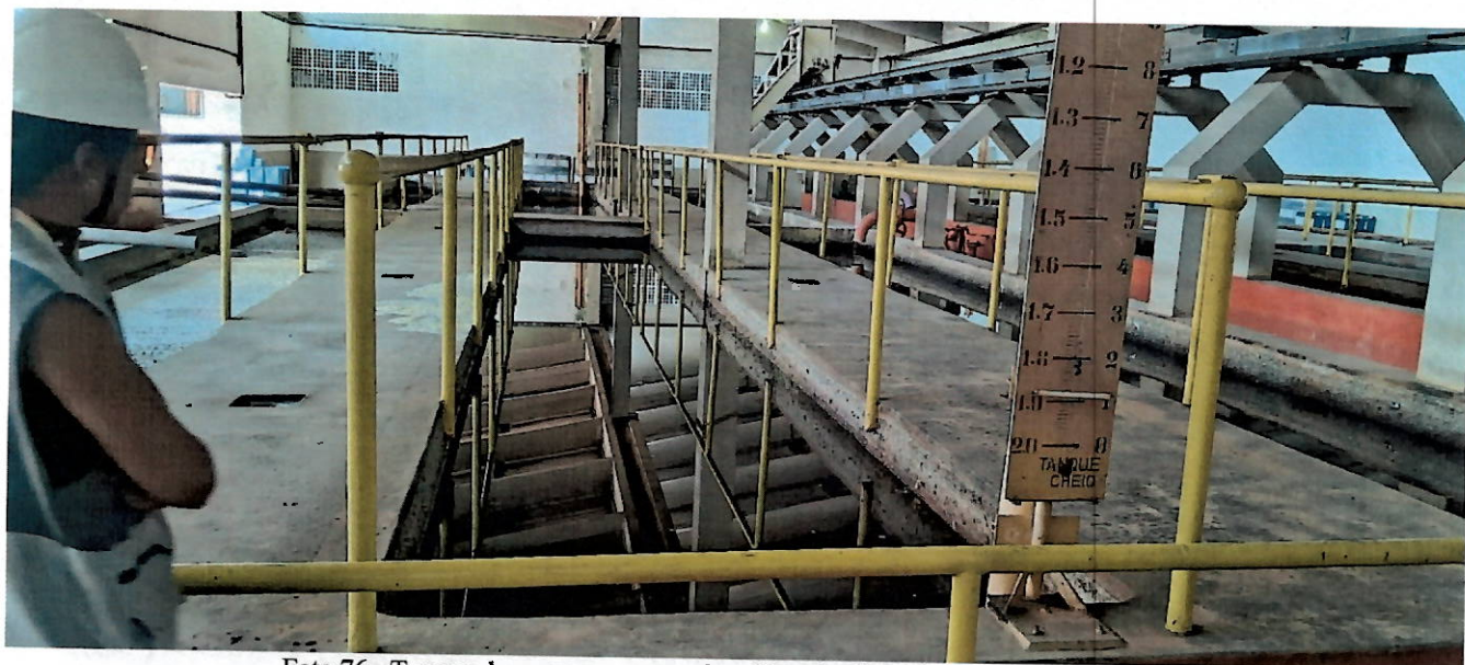
Foto 76 - Tanque de armazenamento de sulfato de alumínio na Casa de Química.
