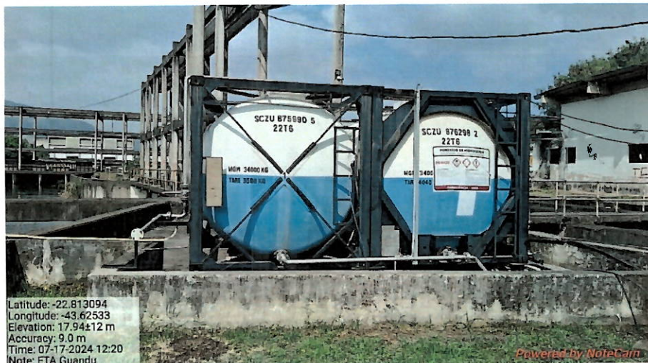
Foto 21 - Tanque de peróxido de hidrogênio que é adicionado à água bruta no desarenador
