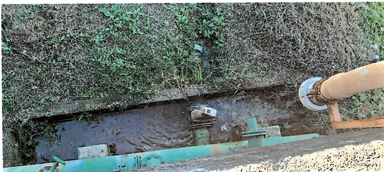
Foto 46 – Registro da tubulação de descarga da floculação com vazamento.
