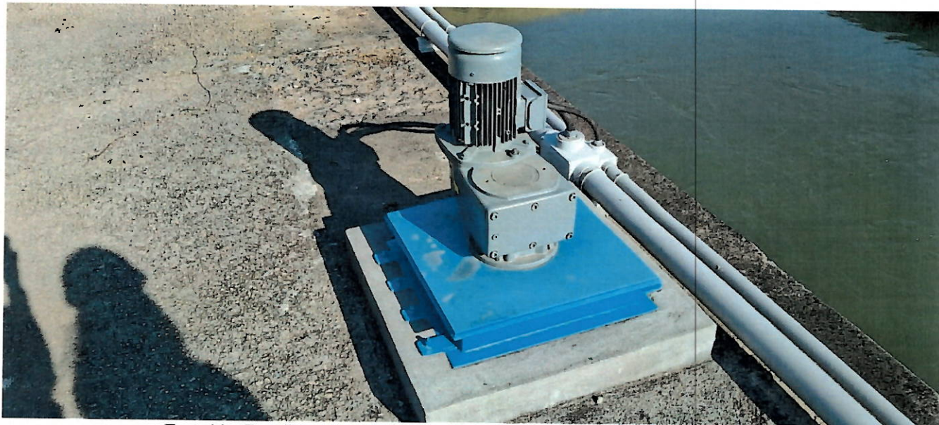
Foto 44 – Detalhe do motor do novo sistema de agitação mecânica instalado.
