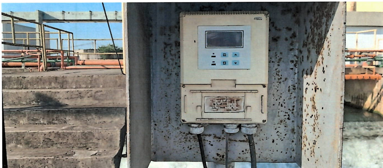
Foto 58 – Equipamento eletrônico de monitoramento da qualidade da água na coagulação inoperante.
