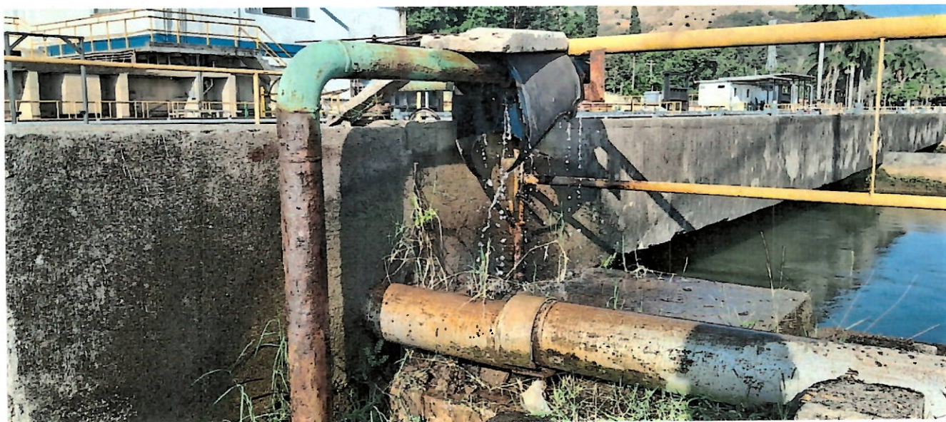
Foto 63 – Vista de registro com vazamento e tubulação com corrosão na área dos floculadores
