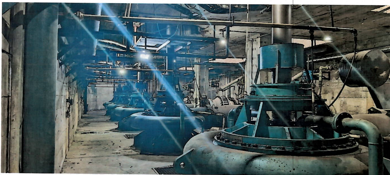
Foto 93 – Interior da Casa de bombas da NARG.
