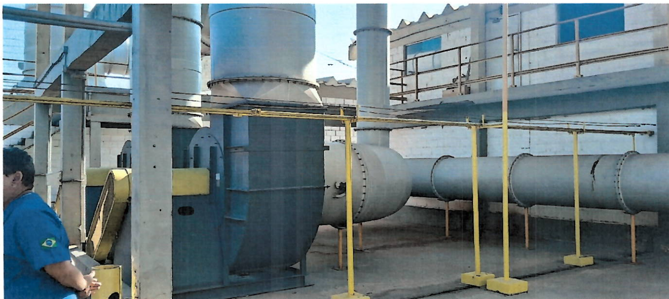
Foto 81 – Equipamento de exaustão e lavagem do cloro
