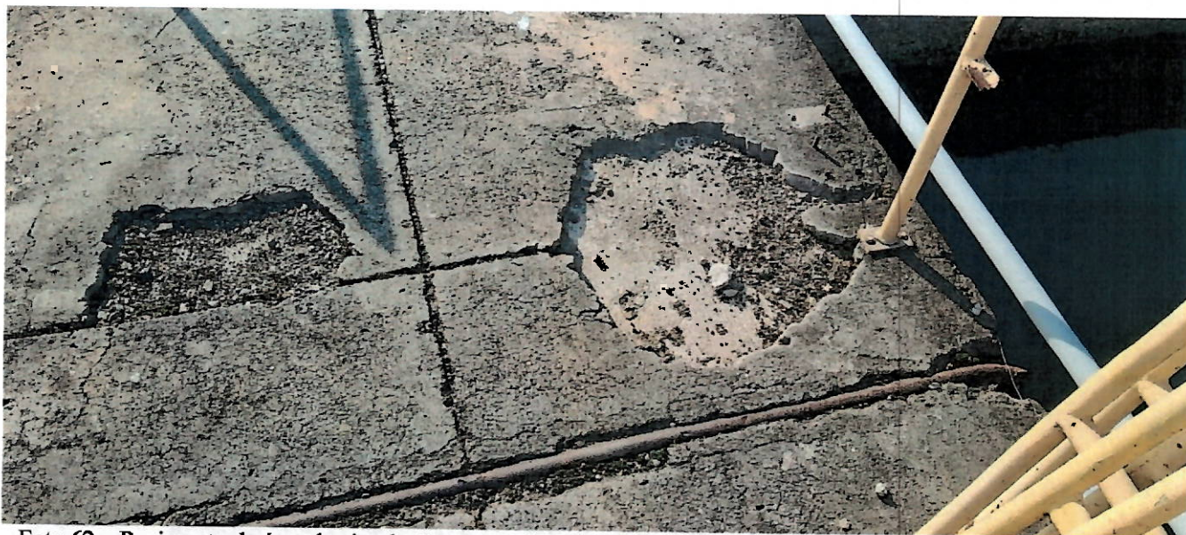
Foto 62 – Pavimento da área de circulação entre os floculadores danificado. Foram verificados outros pontos com danos no pavimento.
