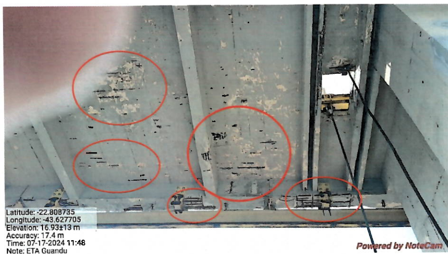
Foto 8 - Ferragens expostas no teto da passarela, na crista da barragem
